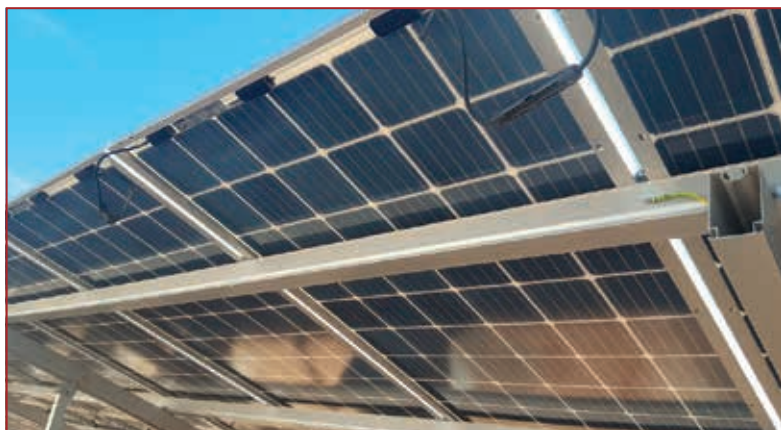
Figura 4.2 - Esempio di moduli fotovoltaici double-face.
